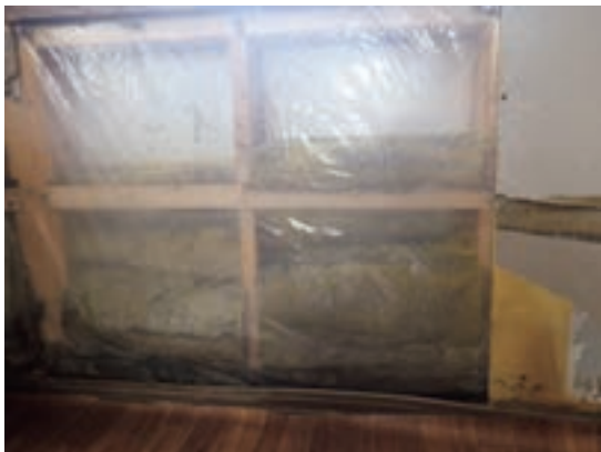
吸水し、脱落した壁内部の断熱材
