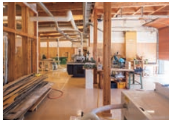
木工加工室：多種多様な木工機械を設置 ※
