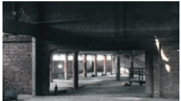
土管が構造柱という危険な状態。鉄骨構造に修復
