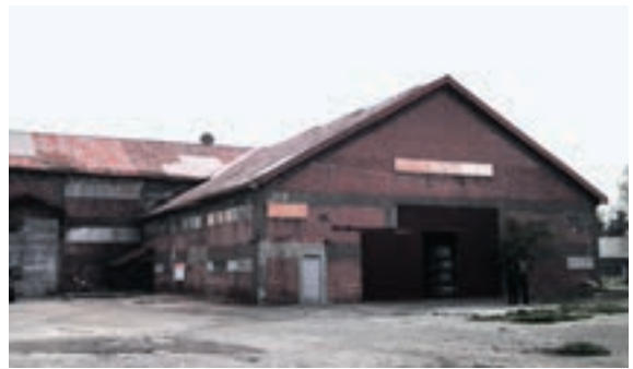
切妻屋根の老朽化やレンガの汚れが目立つ（修復前）
