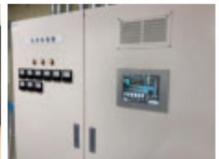
BEMS 熱源制御装置
