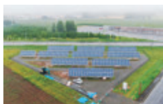
太陽光発電設備
