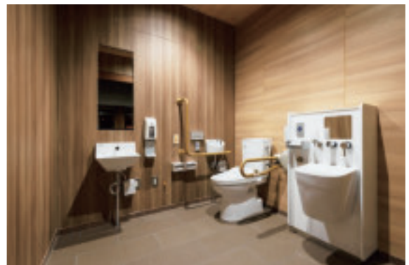
使い勝手を考慮したバリアフリートイレ
