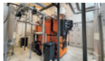
木質チップボイラーにてエネルギー化
