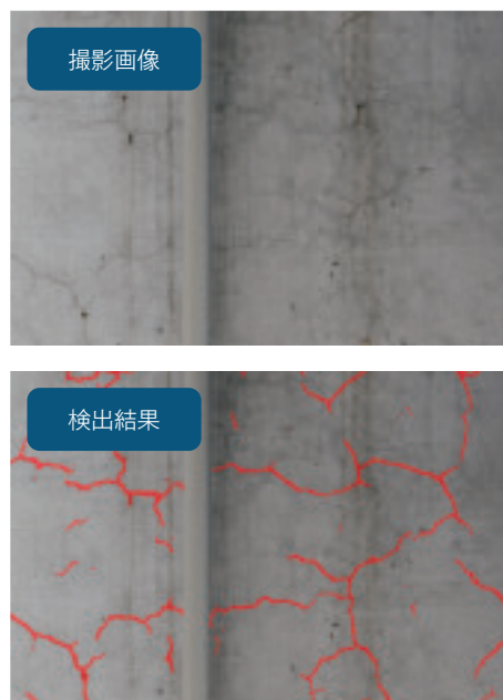
図9 ひび割れの AI 検出結果の例
