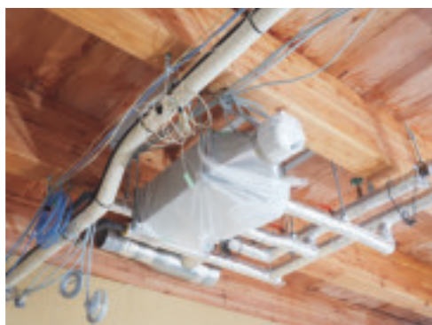
写真5 実装した換気予熱用熱交換装置
