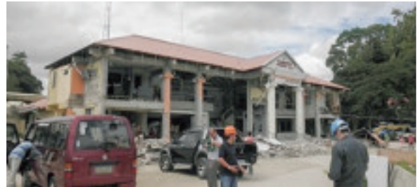
写真1 サグバヤン市庁舎：CB造の外壁や間仕切り壁がほぼ全て崩落 （写真提供：橋府龍雄氏）
