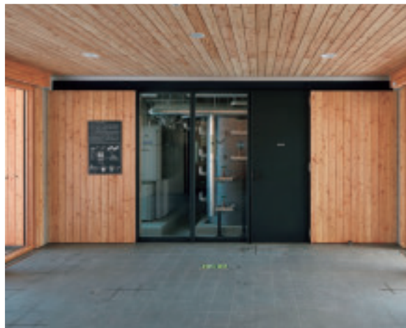
見える化された機械室
