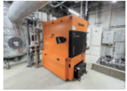
バイオマスボイラー
