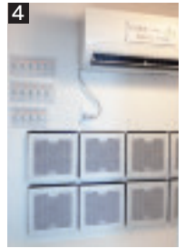
空調室に設置した14畳用エアコン1台+ファンで全館冷暖房を行う空調システム。
