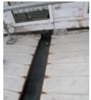
屋根板金のサビ・サイディングのはがれ
