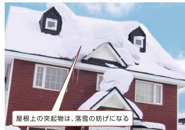
■写真:2 複雑な屋根形状での落雪障害
