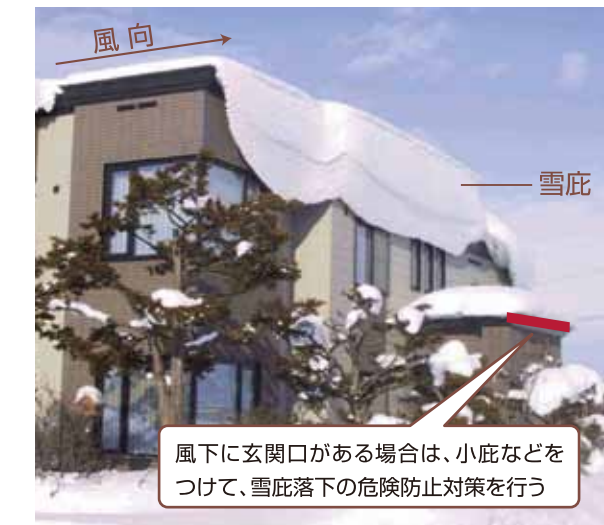
■写真:9 建物の風下側に発生した雪庇
