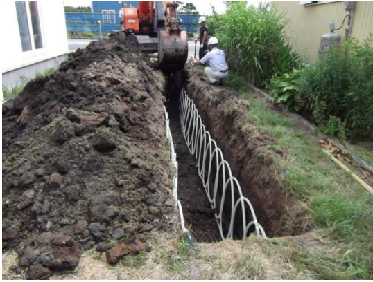
写真 1 水平採熱式地中熱ヒートポンプ
