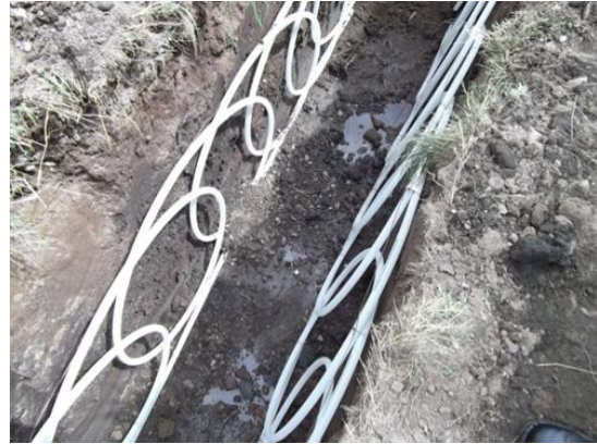
写真 2 水平に設置された熱交換用のパイプ
